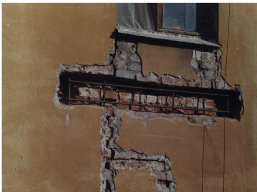
شکل ۴- مقاوم سازی دیوارهای ترک دار
