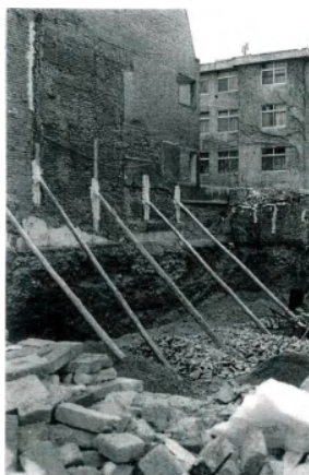
شکل ۱- نمونه ای از اجرای غیر اصولی تیرکهای مایل چوبی جهت نگهداری ساختمان همسایه در حین گودبرداری
